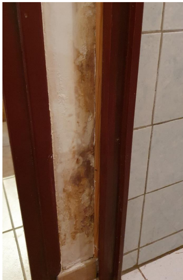
Figure 13 : traces de salpêtre et humidité excessive à l'entrée de la salle de bain
