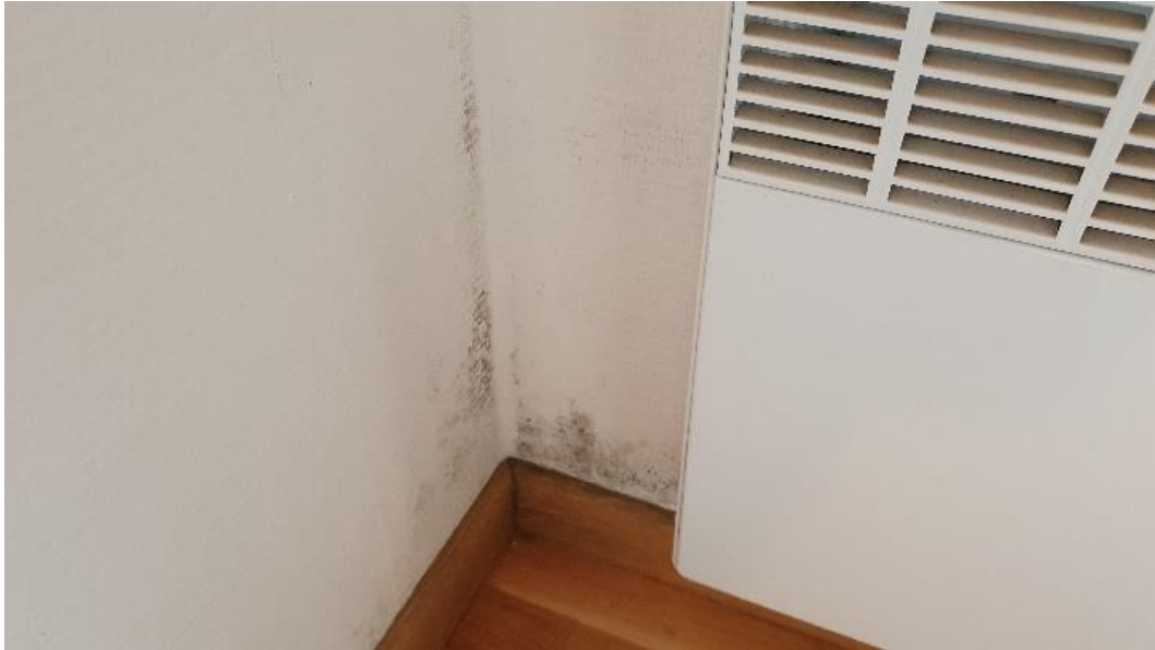
Figure 12 : traînées noires dans la chambre 2
