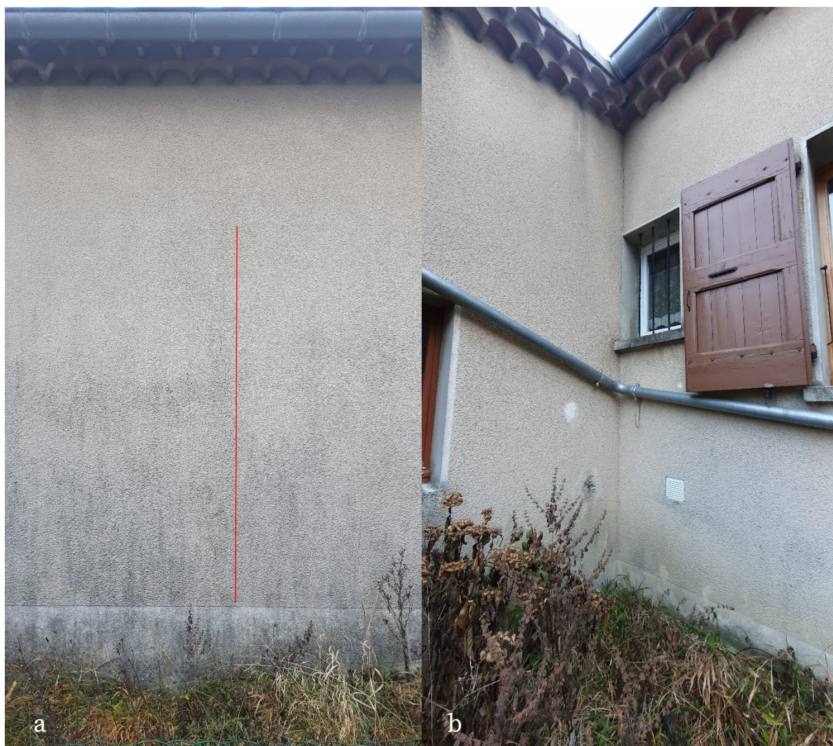
Figure 5 : a) fissure verticale sur la façade est du garage ; b) fissure verticale à la jonction avec la maison
