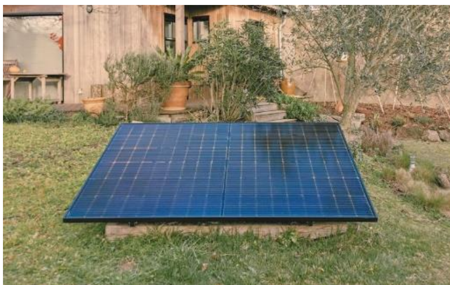
Figure 23 : exemple d'installation photovoltaïque au sol (©Mastation-solaire)
