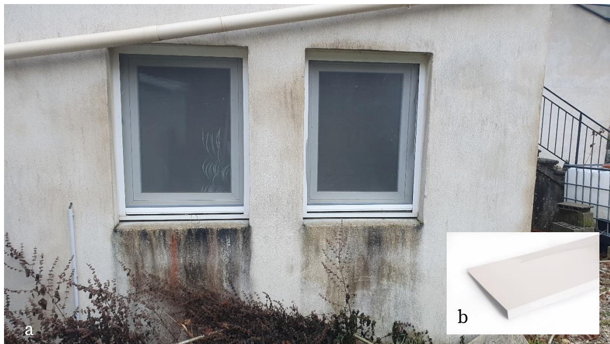
Figure 8 : a) traînées noires et rouges sous les fenêtres de la miellerie ; b) exemple d'appui de fenêtre en aluminium (© Leroy Merlin)
