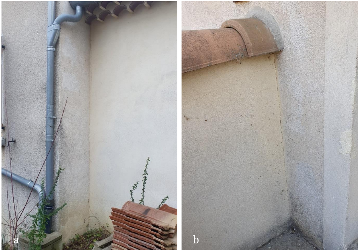
Figure 7 : fissures verticales aux jonctions de la miellerie a) côté l'est ; b) côté ouest
