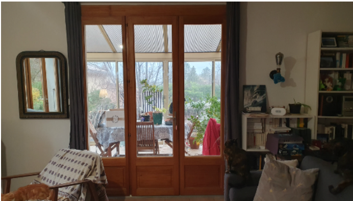
Porte-fenêtre présentant un défaut de fermeture
