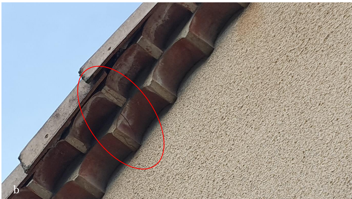
Figure 3 : a) vue générale de la fissure en escalier du mur sud ; b) détail de la fissure au niveau des tuiles
